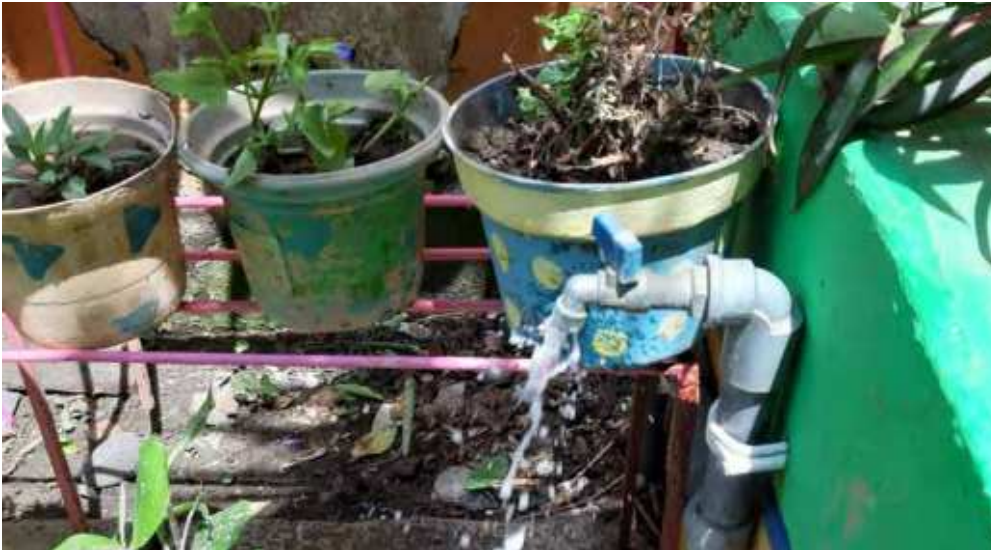
Grifo DEWATS para agua reutilizada en Abbulo Sibatang
