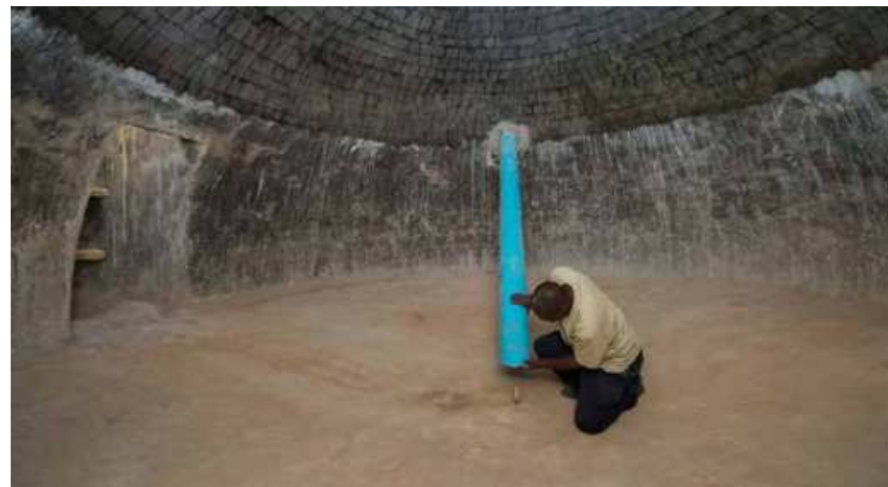
Interior del digestor de biogás de Chazanga
