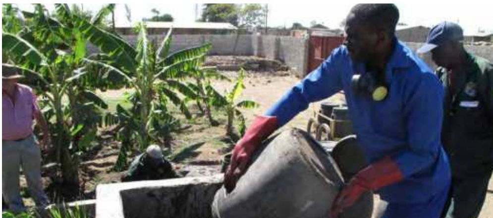
Trabajador de la FSTP de Kanyama vaciando los lodos
