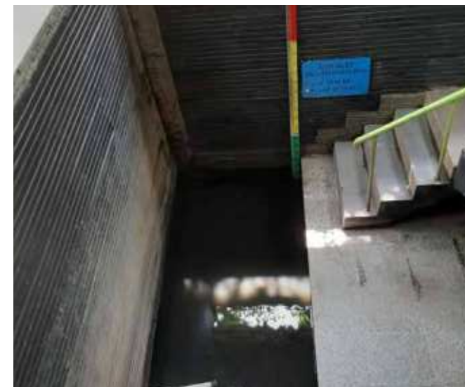
Estación de bombeo de aguas residuales
