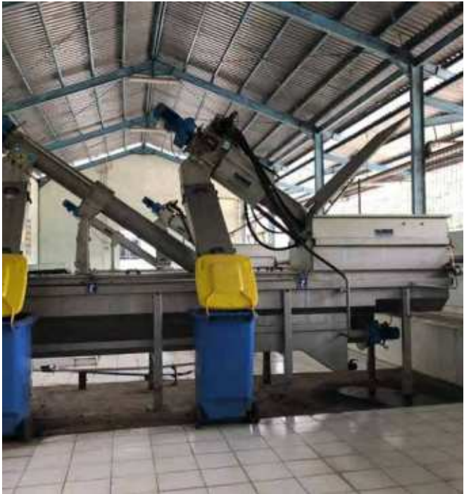
Cribado mecánico de lodos mediante planta de aceptación Huber
