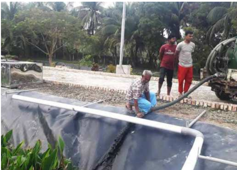
Operadores que vierten el afluente directamente en un lecho de humedal construido plantado
