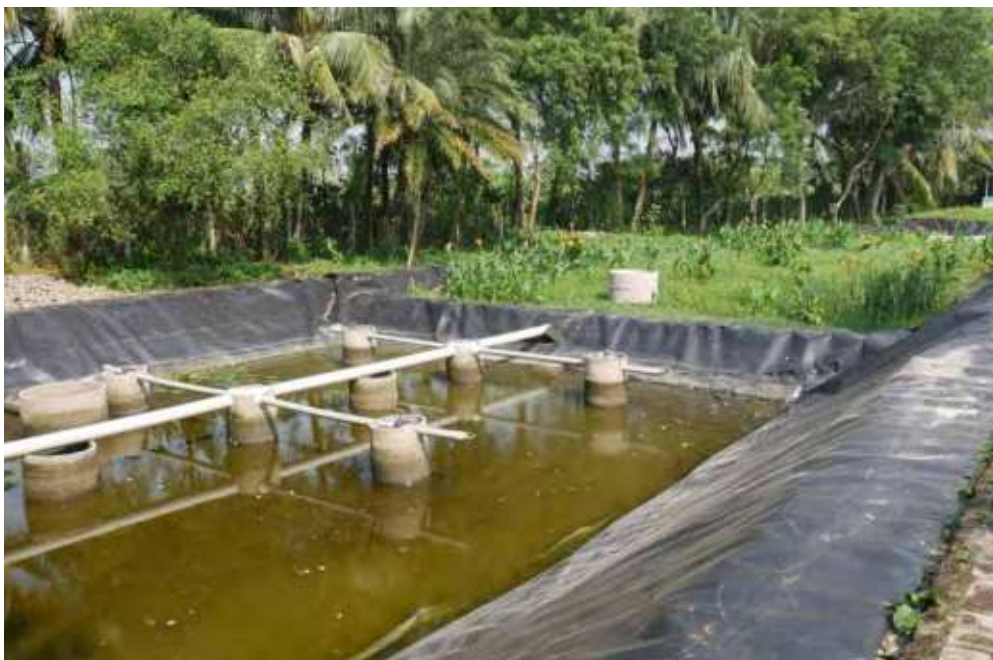
Los niveles de DBO del agua tratada son significativamente inferiores a los del agua del canal junto a la FSTP
