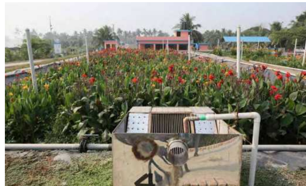
Criba manual de barras para eliminar la basura de los lodos que se vierten en el humedal construido de flujo vertical
