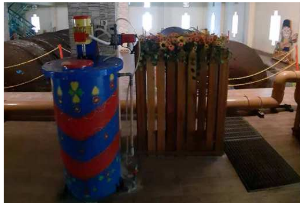
Unidad de dosificación de desinfectante, con el clarificador final por debajo de las baldosas fotografiadas
