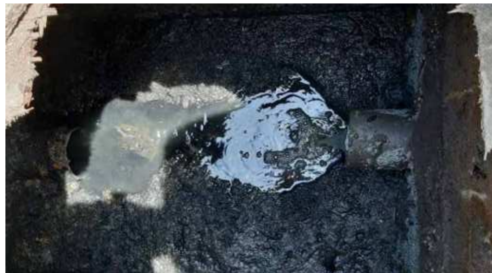
Entrada del DEWATS
