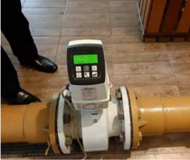
Caudalímetro automático de entrada
