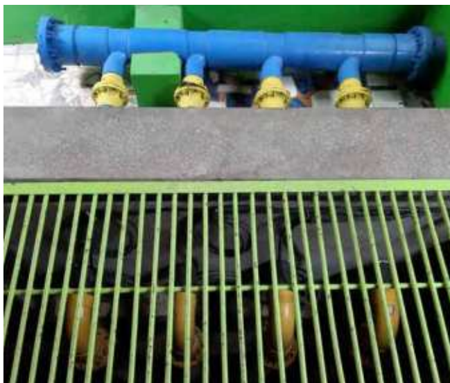
Criba de barras con bomba sumergible
