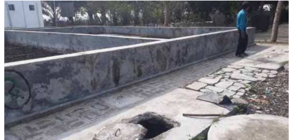
Tanques de reserva que drenan el agua de los lechos de secado de lodos
