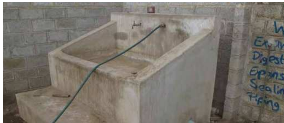
Cubeta de lavado para la limpieza de barriles en la FSTP de Kanyama
