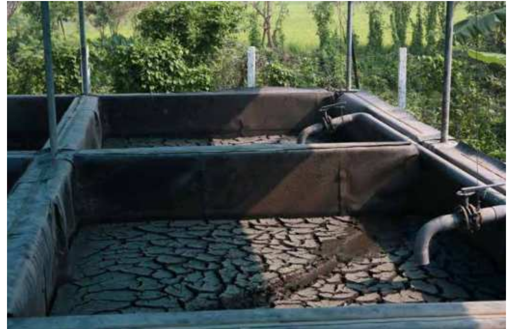
Lechos de secado de lodos
