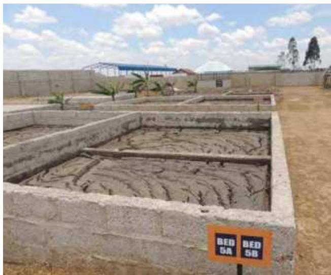
Lechos de secado revestidos pero no techados en la FSTP de Kanyama
