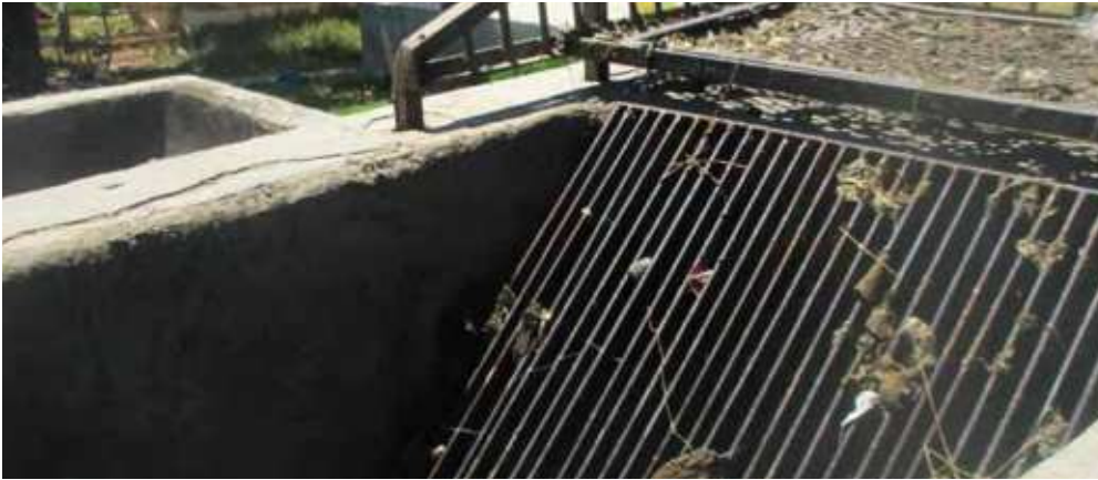
Separação de areia de Chazanga FSTP no ponto de descarga influente
