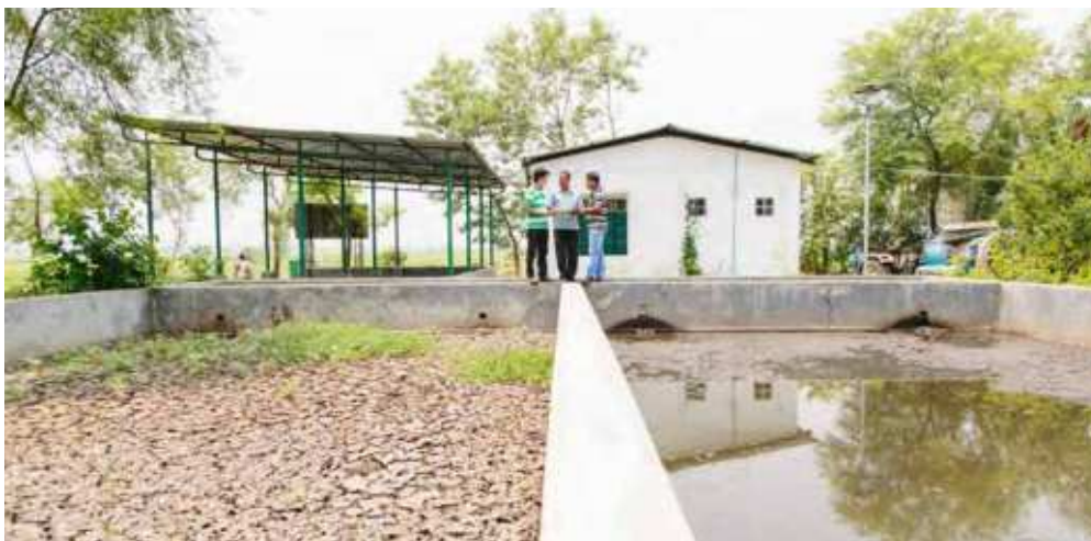
Camas de secagem de lodo na FSTP de Kustia
