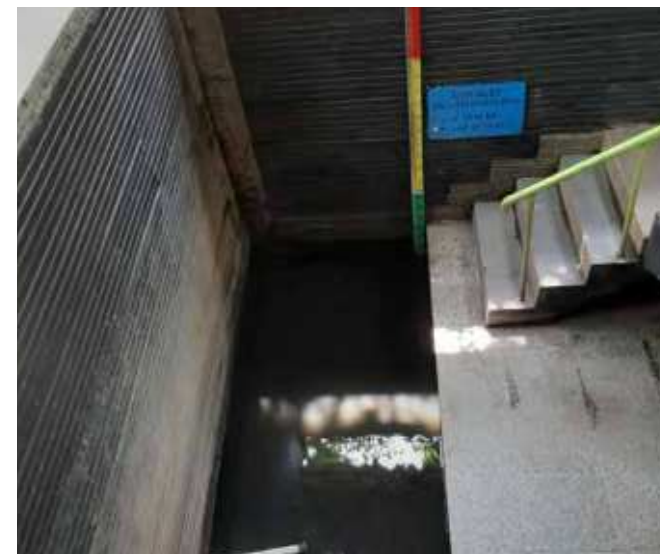
Estação de bombagem de esgotos
