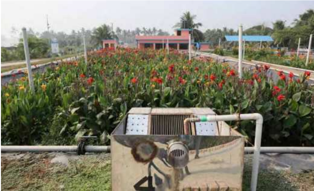
Ecrã de barra manual para remover detritos de lodo descarregadas na zona húmida de fluxo vertical construída
