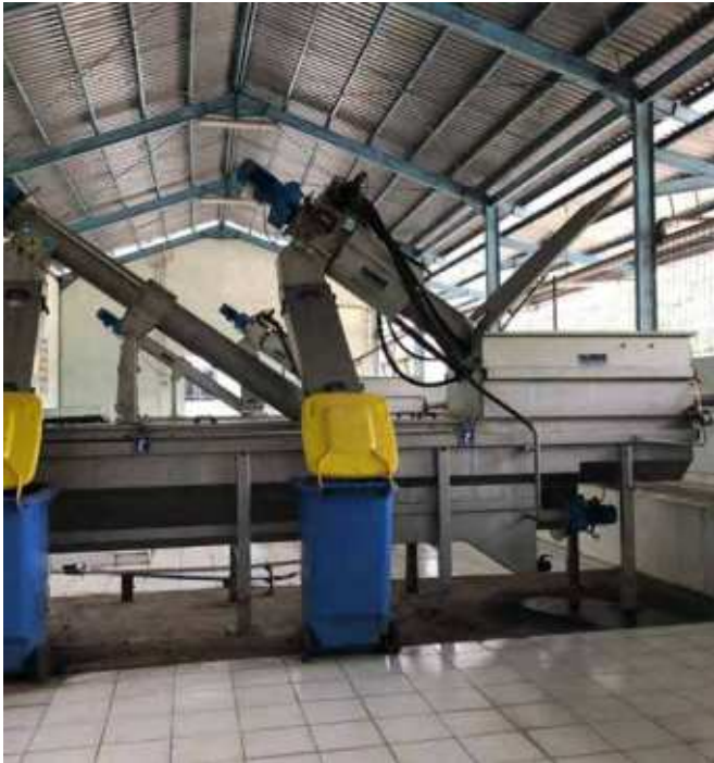
Crivagem mecânica de lodo por meio de planta de aceitação Huber
