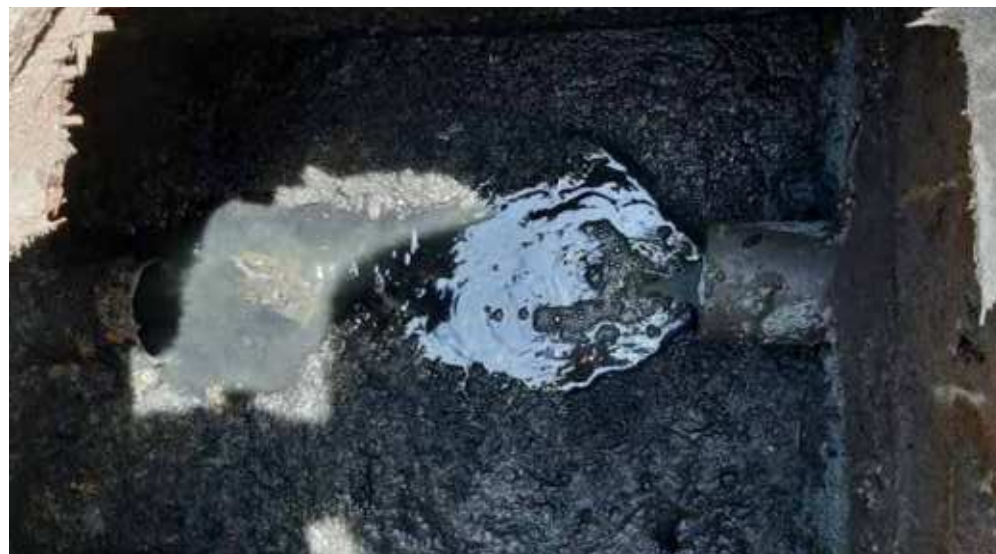
Entrada do DEWATS
