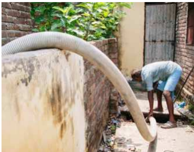
Eliminação de lodo de contenção domésticas
