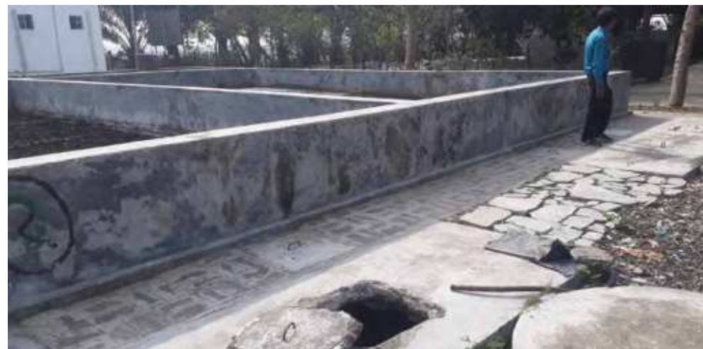
Reservatórios de drenagem de água dos leitos de secagem de lodo
