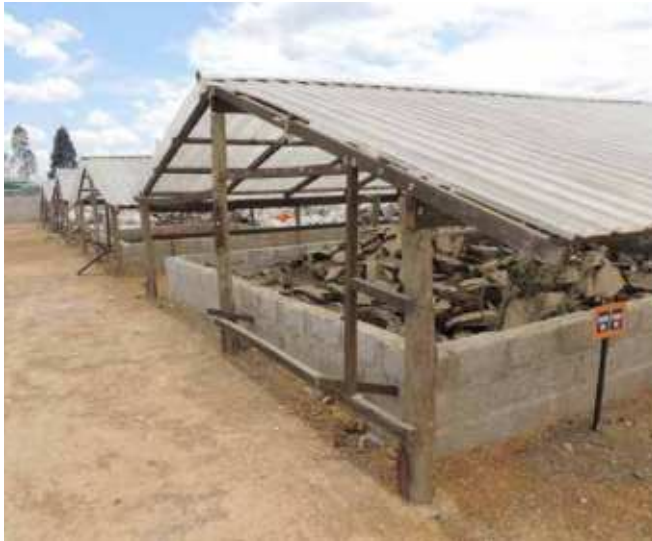
Camas de secagem de lodo de telhado na FSTP de Kanyama
