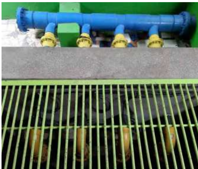
Ecrã de barras com bomba submersível
